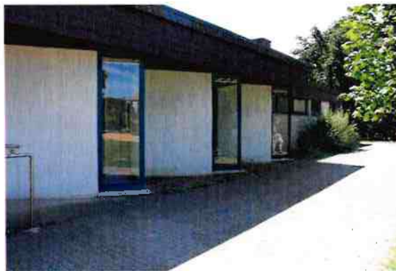
Abb. 220: Bürgerhalle: sanierungsbedürftig Quelle: Stadt Jülich / Planungsgruppe MWM
