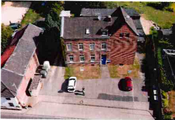
Abb. 50: Alte Schule: sanierungsbedürftig Quelle: Stadt Jülich / Planungsgruppe MWM
